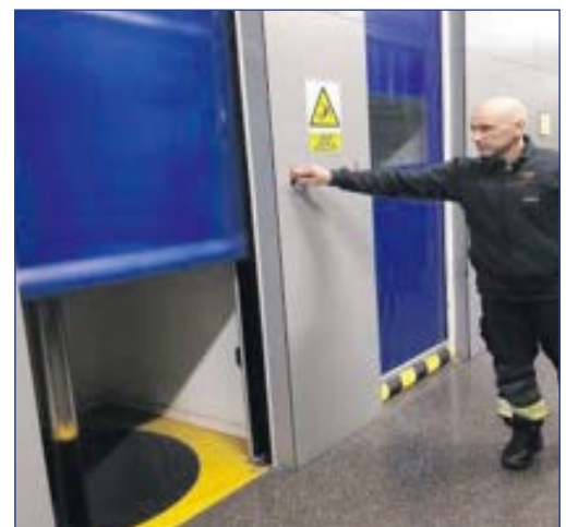
Polsador d'obertura al parc de Montjuïc, il·luminació de l'espai de descens, cortina de plàstic protectora de l'accés a l'espai
