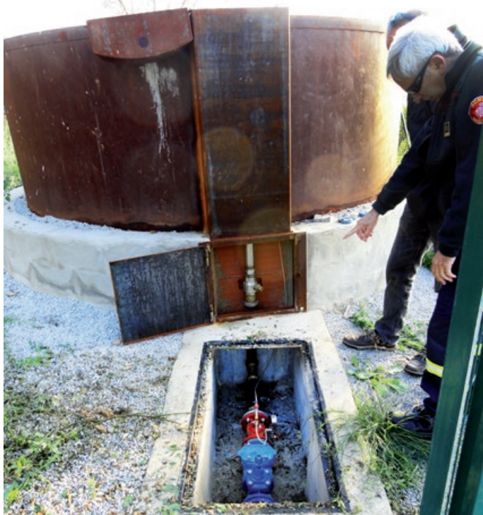
Un dels dipòsits que hi ha al voltant de la carretera de les Aigües i que es poden aprofitar per abastir el sistema.
